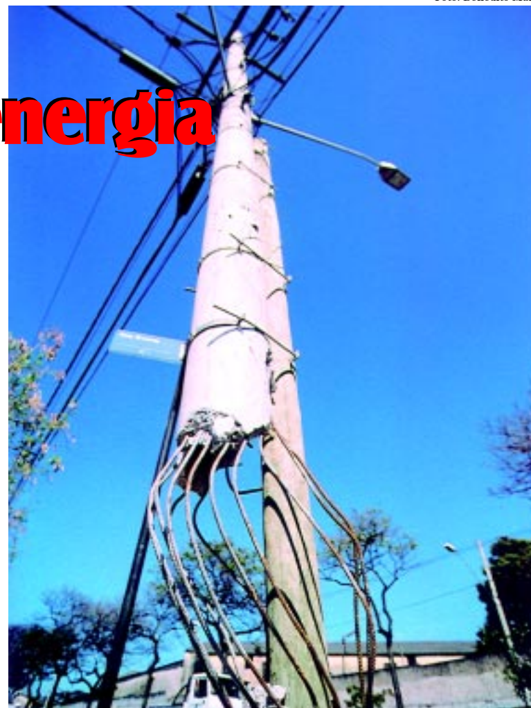
Cemig recomenda escoramento de postes podres
